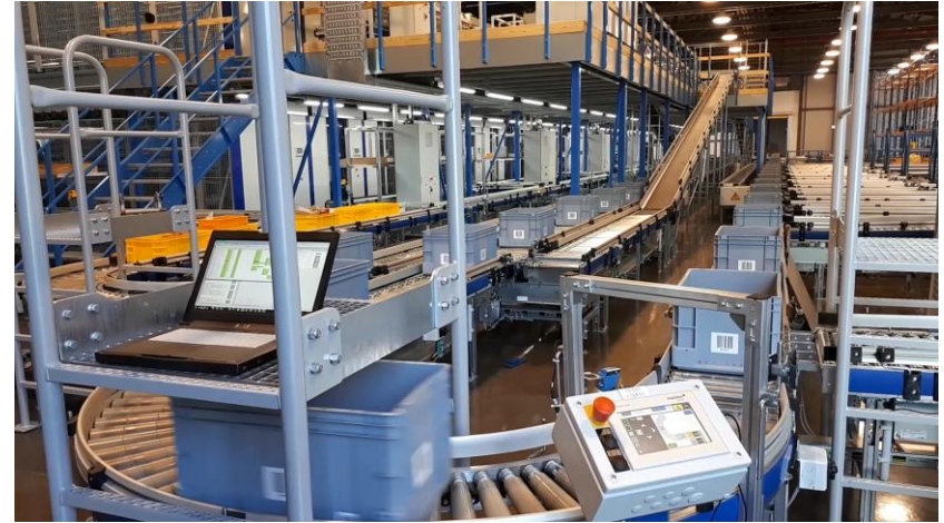
Realbetrieb der Anlage
